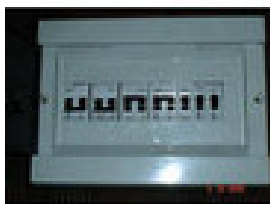
Quadro de distribuição
